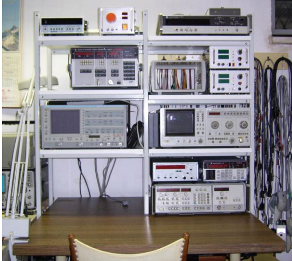
Abb. 8: Der fertiggestellte Meßplatz. In der Zwischenzeit sind im Gestell zu den Meßgeräten auch einige Netzgeräte hinzugekommen.
